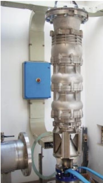
FASE DI INSTALLAZIONE DI UNA DELLE TRE ELETTROPOMPE SOMMERSE ROVATTI 14EX-650
