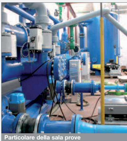
Particolare della sala prove
